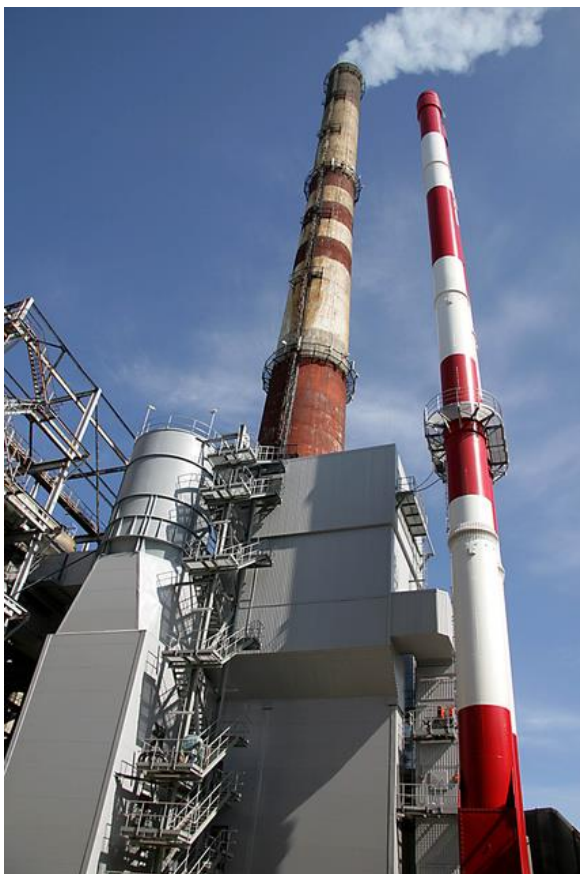
Foto 17. Väävliärastus VKG Energia OÜ Põhja soojuselektrijaamas.
